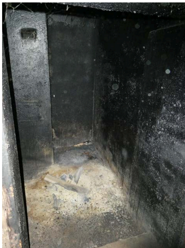
Kjellerrom med sot på overflater.
