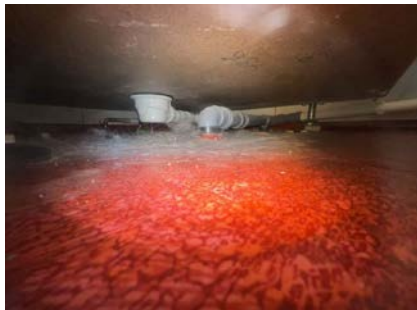
Sprekkdannelse/rift i beleggoppkant rundt avløpsrør i gulvflaten.
