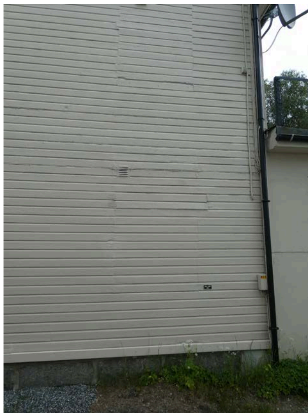
Slitasje på ytterkledning. Innlappet kledning i blendet vindusåpning.
