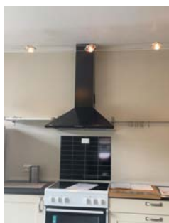
Avtrekk via ventilator over komfyr
