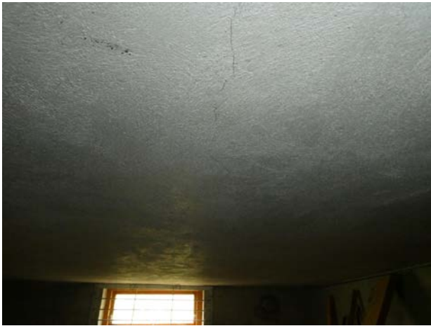
Riss/mindre sprekkdannelse i underside - etasjeskille mellom kjeller og 1.etasje.
