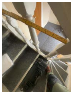
Åpninger i rekkverk større enn 10 cm.
