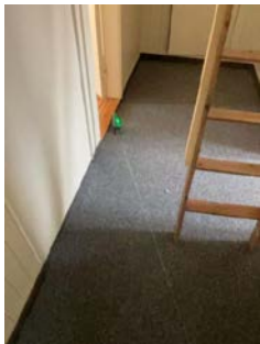
Målt høydeforskjell på gulvflate.
