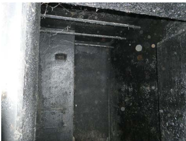
Kjellerrom med sot på overflater.
