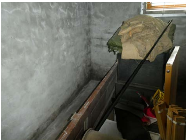
Fuktskjolder/saltutslag på mur/betonggulv
