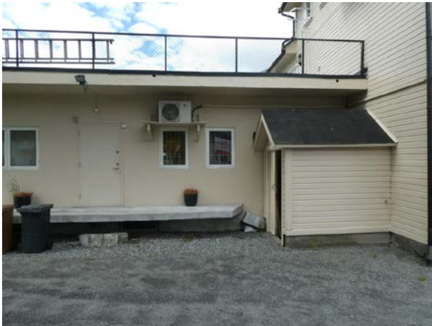
Balkongdekke uten rekkverk.
