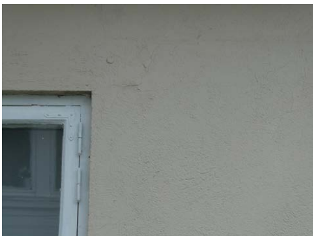
Riss og mindre sprekkdannelser i utvendig betongveggfasader.
