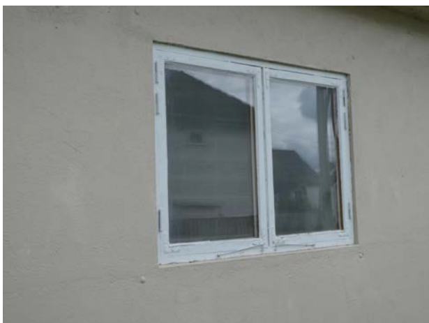
Sprekkdannelse under vindusåpning.
