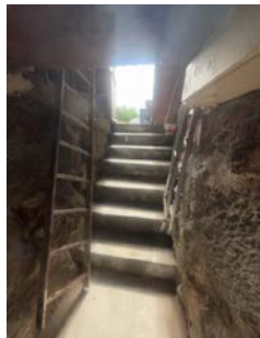
Ikke montert rekkverk/håndrekke i kjellertrapp
