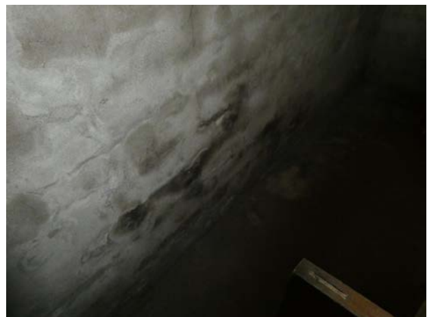
Fuktskjolder/saltutslag på mur/betonggulv.
