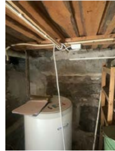
Tilkobling til strøm via stikkontakt.
