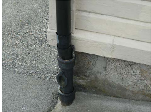
Mindre sprekker i betongfuger mellom naturstein.
