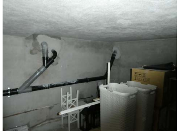
Avløpsrør av plast - nyere dato
