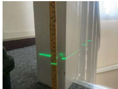
Målt høydeforskjell på gulvflate.
