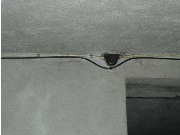
Små riss i muroverflate - innvendig.
