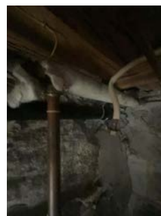
Isolasjon rundt kobberør - ukjent om kan inneholde asbestmateriale
