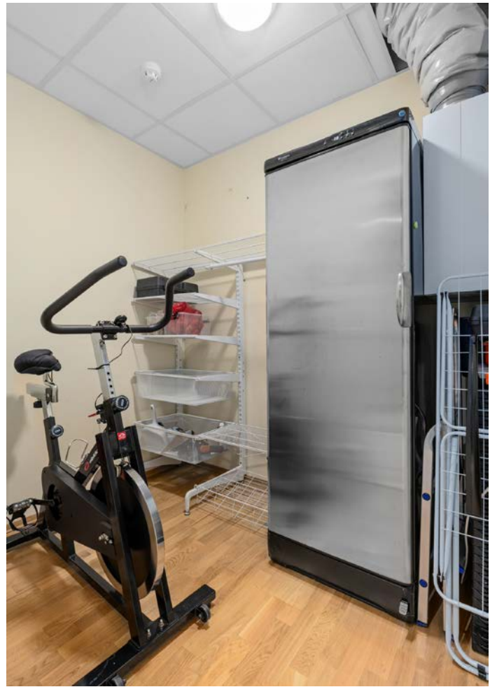
Innvendig bod/teknisk rom med ventilasjonsaggregat og god oppbevaringsplass
