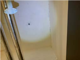
Eksempel på hull i betonghimling.
