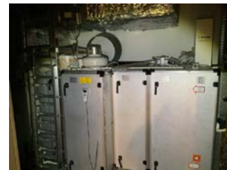
Motor til ventilasjon i teknisk rom
