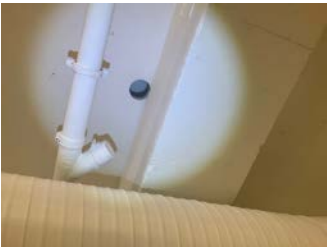
Eksempel på hull i betonghimling.
