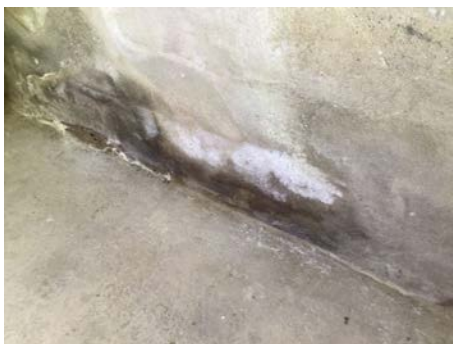
Saltutslag i kjeller
