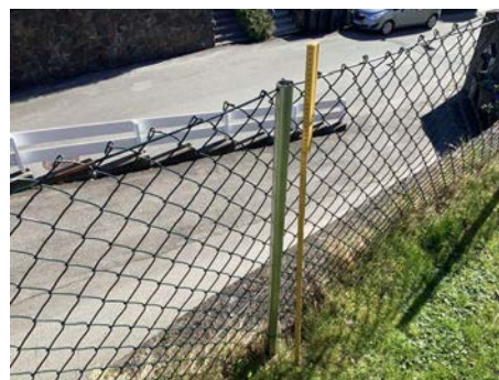
Høyde på rekkverk
