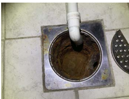
Rust i gammel støpejernsluk på vaskerom
