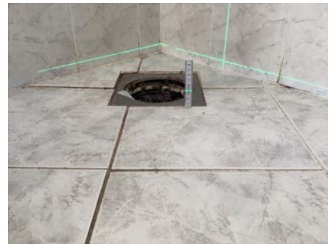
Måling ved sluk under kabinett
