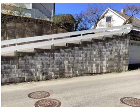
Saltutslag på mur
