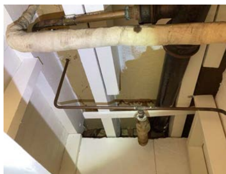
Vannledninger i kobber
