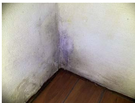
Saltutslag på vegg
