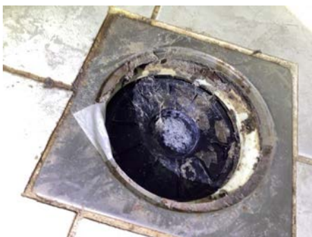
Ukjent membran / tettesjikt i sluk under kabinett
