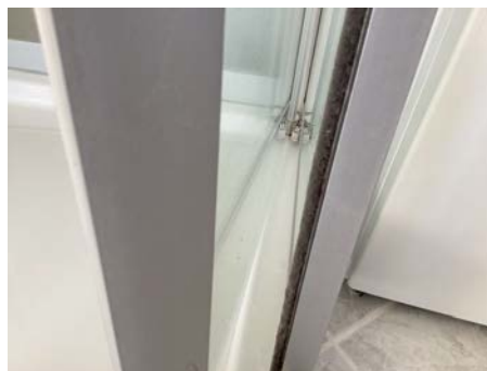
Slark i dør til kabinett
