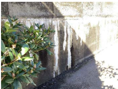
Saltutslag på nedre del
