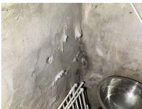
Saltutslag i kjeller
