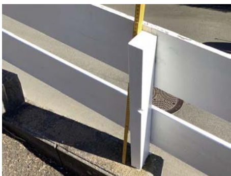
Lav høyde på rekkverk
