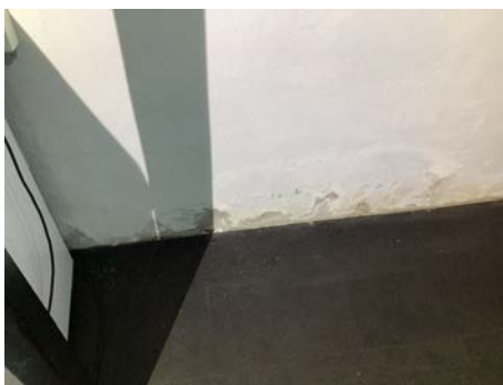
Saltutslag i kjeller
