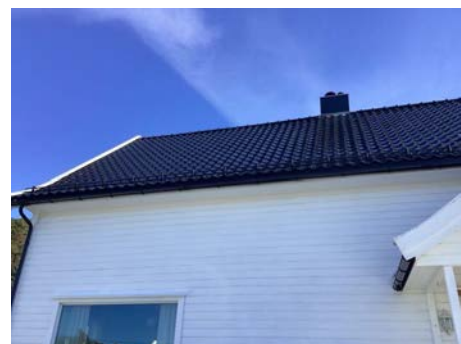
mindre sig i takkonstruksjon
