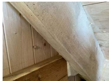
Spor etter stripet borebiller i konstruksjonen
