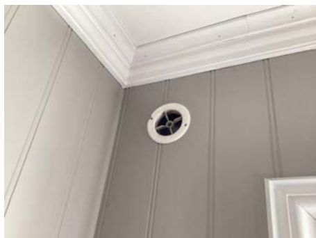
Ventil i yttervegg
