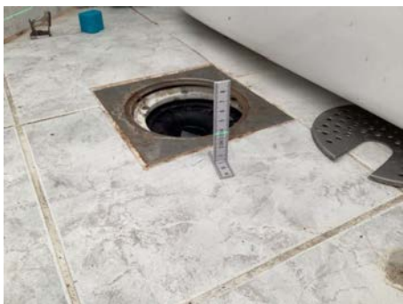
Måling ved sluk under badekar
