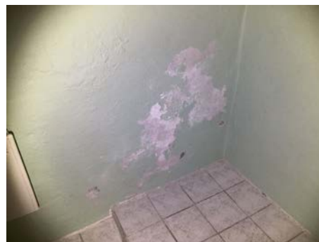
Saltutslag på innvendig mur
