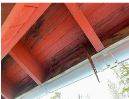
Råte i takkonstruksjon.
