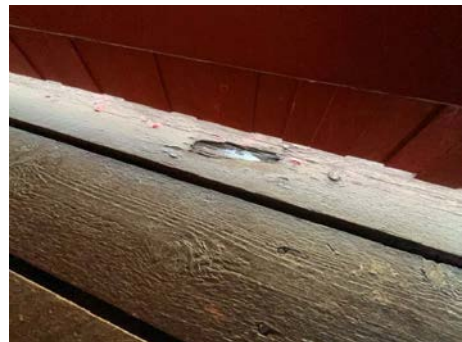
Råte i terrassebord.
