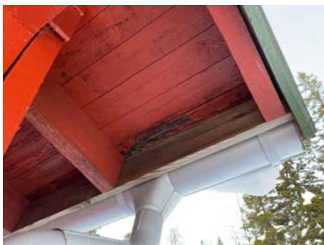
Råte i takkonstruksjon.
