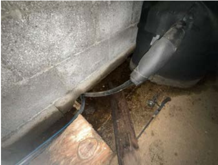
Utvendige vann og avløpsrør.
