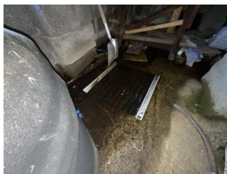
Stående vann i krypkjeller.
