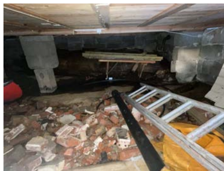
Stående vann i krypkjeller.
