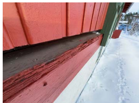
Råte i terrassebord.
