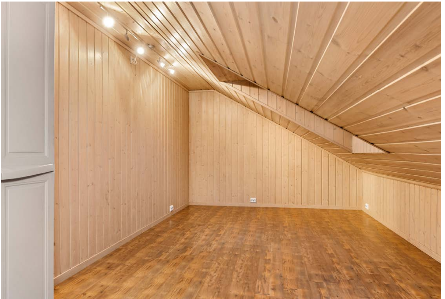
Innredet rom på loft (loftsrom er ikke byggegodkjent)
