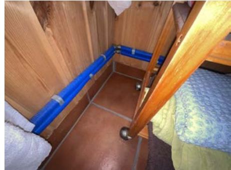
Rør-i-rør ført på vegg.
