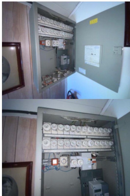
Mangler deksler og litt løse sikringer.
