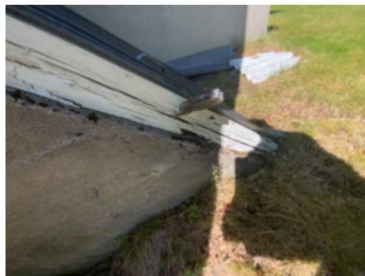
Råte i ramme til luke ned til kjellerdør.
