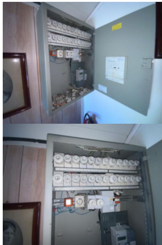
Mangler deksler og litt løse sikringer.
