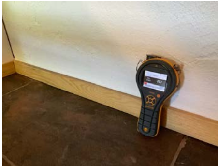
Svake fuktutslag registrert på nedre del av murvegg under trappen
