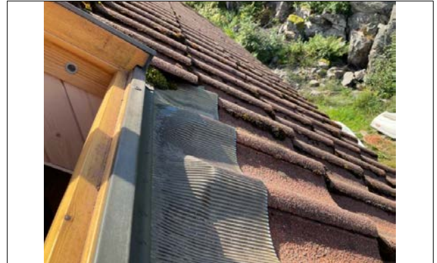
Beslag/tekkning rundt takvindu er slitt og oppnådd høy alder
