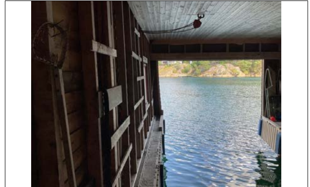
Endevegg har synlig og målbar skjevhet/loddavvik
