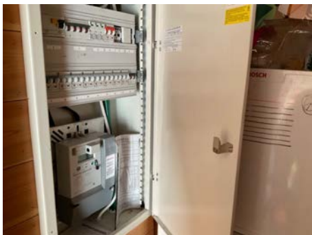
Sikringskap utleiedel. Dokumentasjon fra installasjon ligger i skapet.
