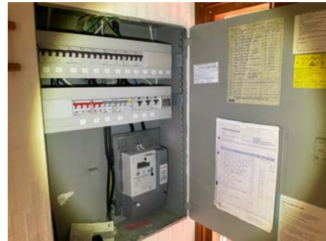
Sikringskap i hoveddel. Diverse dokumentasjon i sikringskap.
