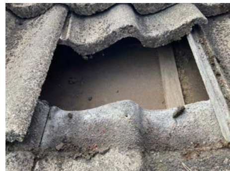
Stikkontroll undertak. Normal slitasje registrert.
