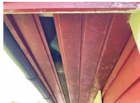
Fluenetting er stedvis løsnet eller slitt. Utskiftinger bør gjøres
