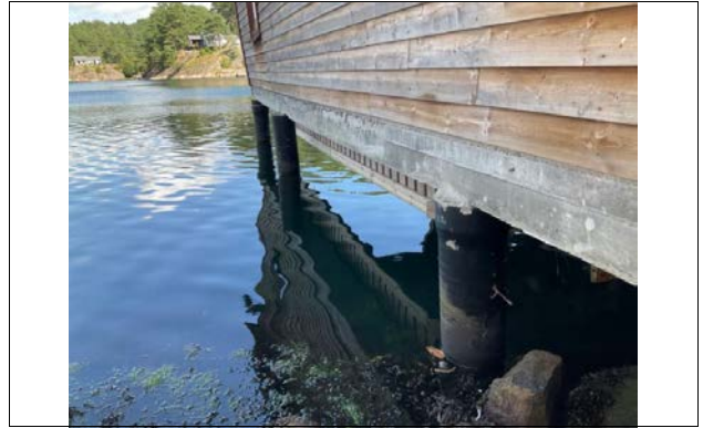
Område hvor det er nedsig og skjevhet
