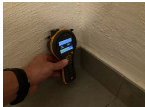
Svake fuktutslag registrert på nedre del av murvegg bodrom
