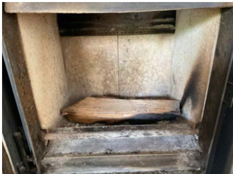
Vedovn i utleiedel, slitasje på brannplater.
