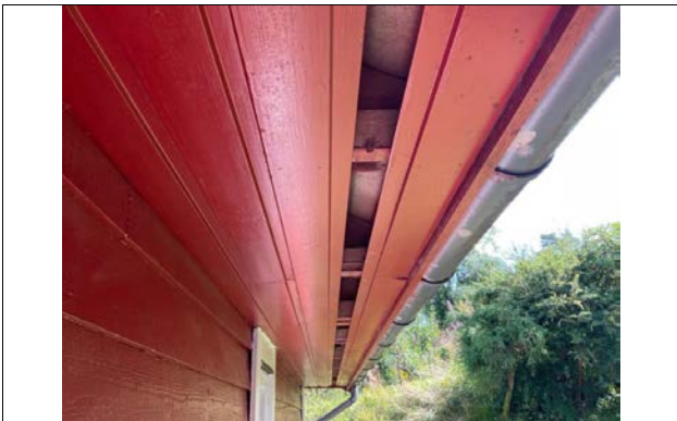
Mangler fluenetting i gesims (garasje)
