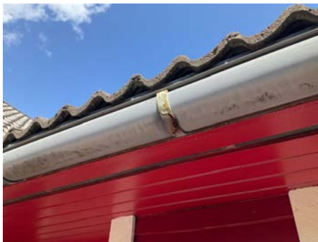
Takrenner på opprinnelig del har slitasje. Rustne oppheng
