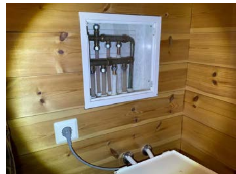
Fordelingskap med rør i rør system, utleiedel
