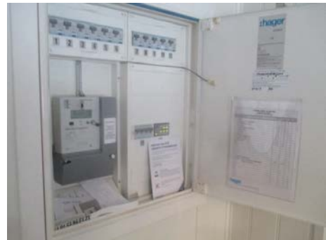
Sikringsskapet er plassert på ene soverommet.
