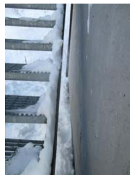
Noe stor åpning i mellom trapp og vegg.
