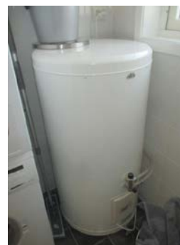
Bereder er plassert på bad/vaskerom.
