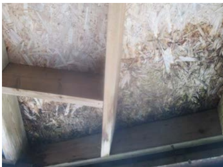
Har vært noe lekkasje ytterst ved rekkverk.
