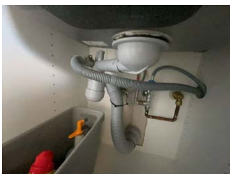
Del av rør til avløp.
