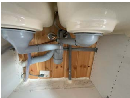
Del av rør til vann.
