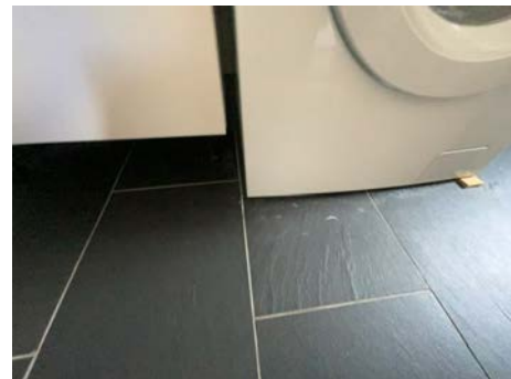
Sluk i gulv er under vaskemaskin.
