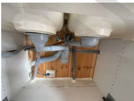
Del av rør til avløp.
