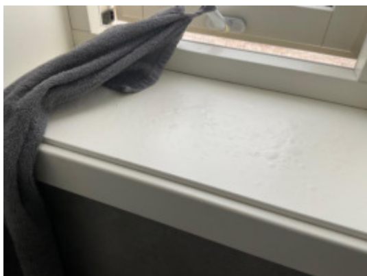
Noe fuktsvelling foring baderom 2 etasje.
