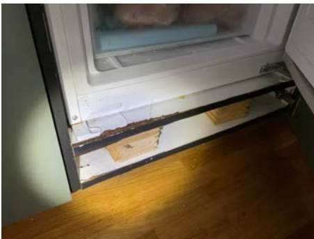
Skader i bunnen av skrog ved innebygd kjøleskap
