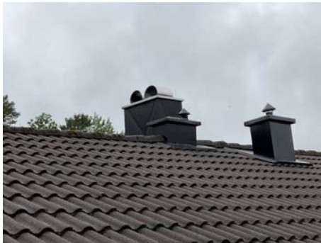
Pipebeslag ser ut til å være skiftet i nyere tid.
