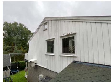
Det er på gavlveggen at det er mest skader.
