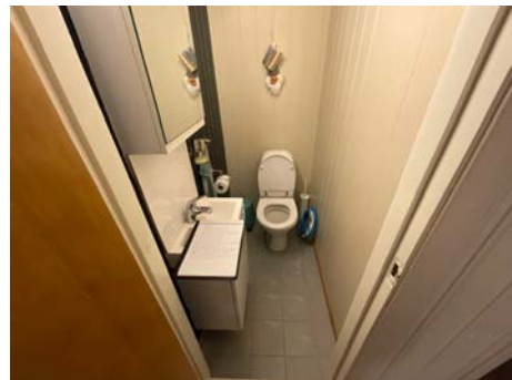
Det var en del misfarge på gulvfliser og døra på innredningen henger.
