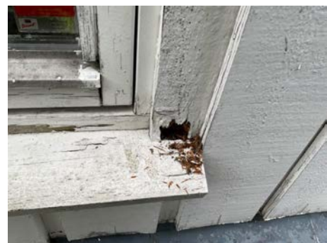
Råte i belistning rundt vindu.
