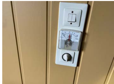
Brytere og kontakter er stort sett fra byggetiden
