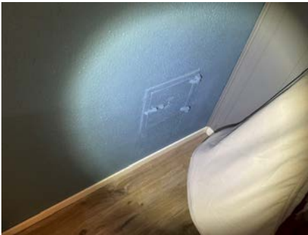
Sotluke i underetasje
