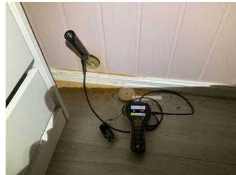
Fuktmåling i bunnsvill på "ny vegg" under inngangsparti. Her var det rett i underkant av 19 vektprosent i treverket.
