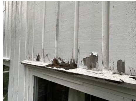
Råteskader i kledning og vannbord
