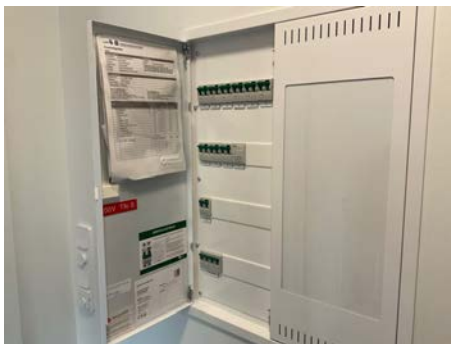
Sikringskap i utleiedel
