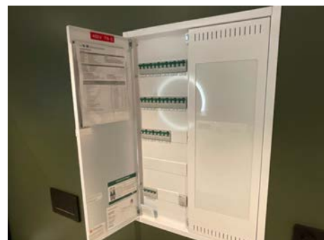
Sikringskap i hoveddel
