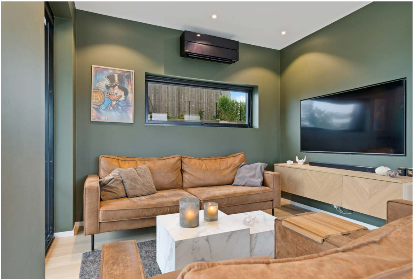
Stue med montert varmepumpe
