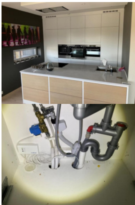
Lekkasjesikring med sensor montert
