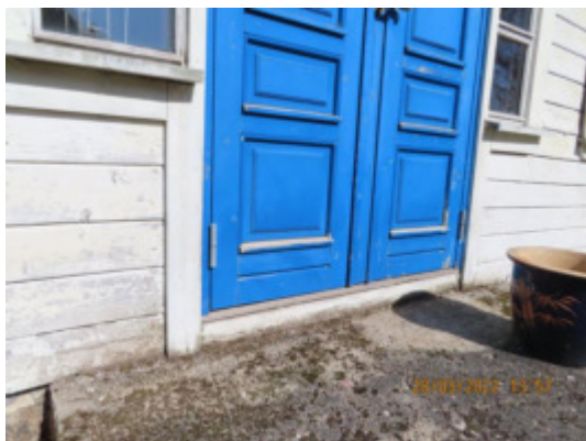
Mye slitasje på "nyere" dør på frontfasade
