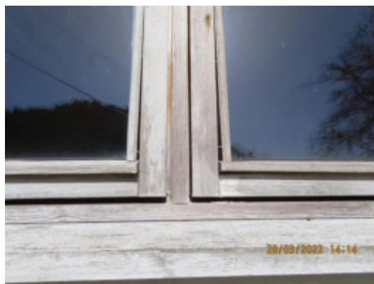
Slitte vinduer fra 2008, bl.a. med løsnet glasslister
