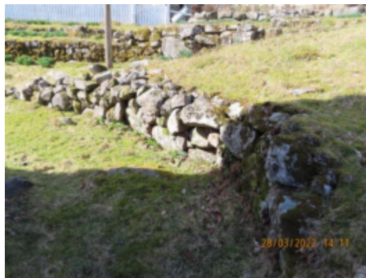
Forstøtningsmur i hage, med dels utglidde steinblokker
