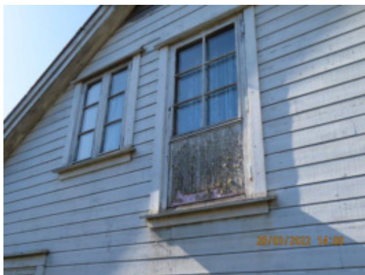
Slitt balkongdør på loft
