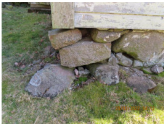
Utglijning av steinblokker i grunnmur
