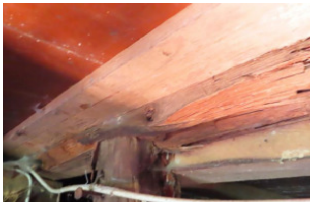
Stedvis råteskader i bjelkelag over krypkjeller
