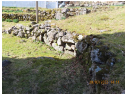
Forstøtningsmur i hage, med dels utglidde steinblokker
