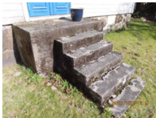
Utvendig betongtrapp har en del skade, og mangler rekkverk
