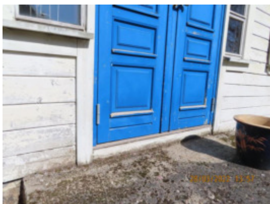
Mye slitasje på "nyere" dør på frontfasade
