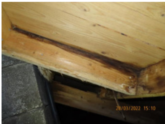
Skade i tak på nedside av elementpipe
