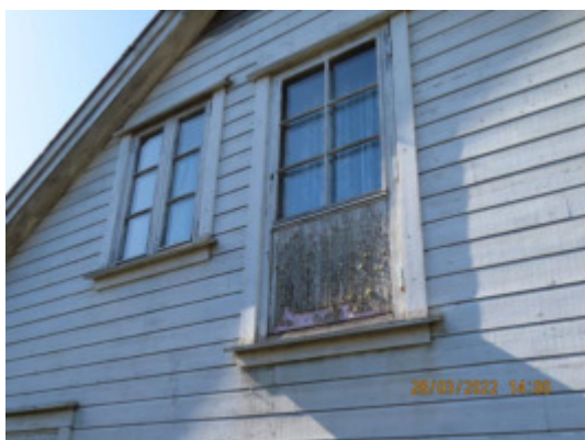
Slitt balkongdør på loft
