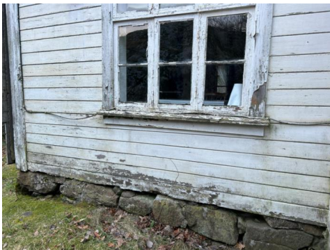
Ingen synlig fuktsikring utvendig
