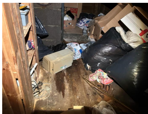
Lekkasje på loft og videre ned i badet.
