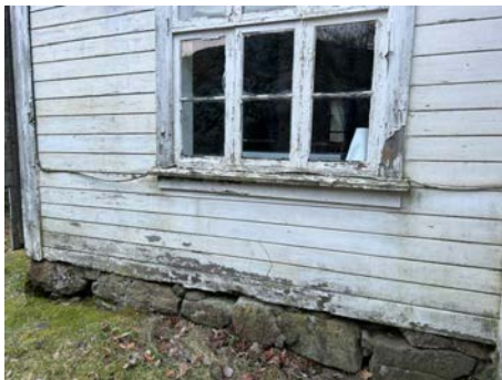
Ingen synlig fuktsikring utvendig
