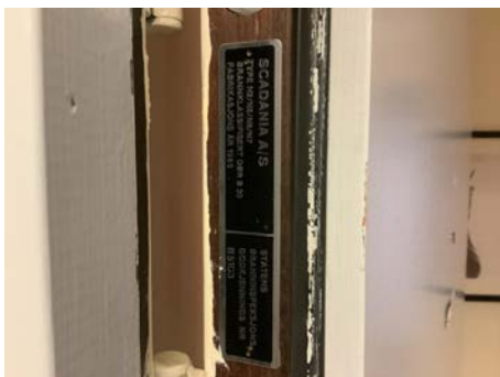
Godkjenningsskilt for brannndør (B30).
