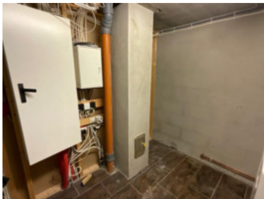
Pipe i 1. etg.
