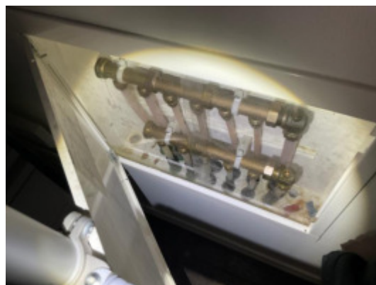
Vannskap i 2etg har avløp til bad.
