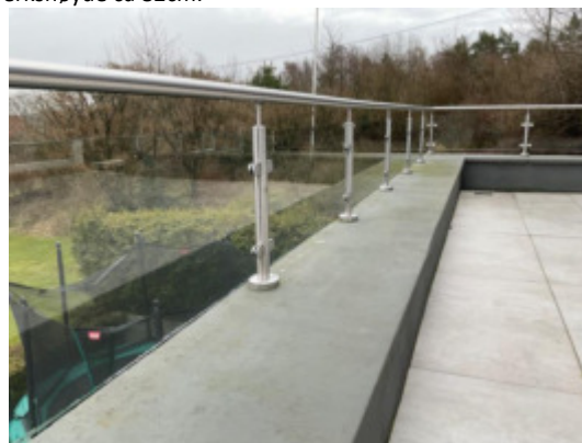
Lavt rekkverk på terrasse i 1etg.
