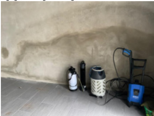
Fuktmerker i garasje
