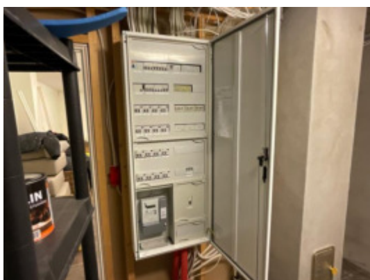
Sikringskap i tekniskrom.
