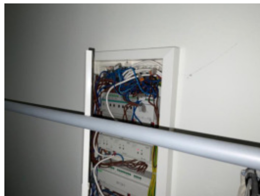
Kablingsskap i 2etg.
