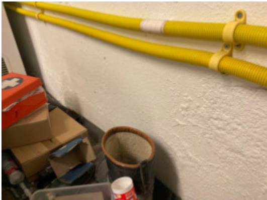
Saltutslag og løs maling i bod uetg.
