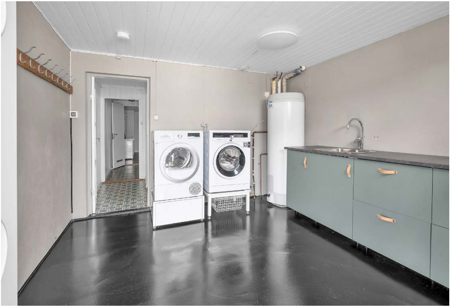
Romslig vaskerom med opplegg til vaskemaskin og tørketrommel. Varmtvannsbereder på 300L.
