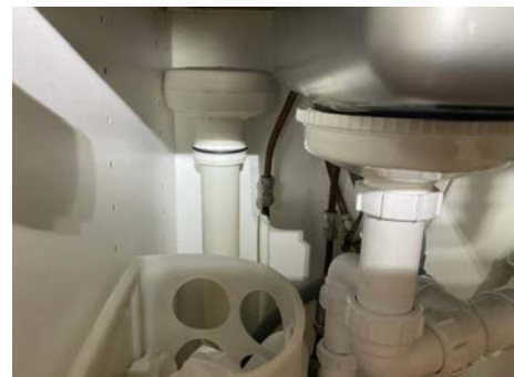
Durgoventil (avløpslufting) i kjøkkenskap
