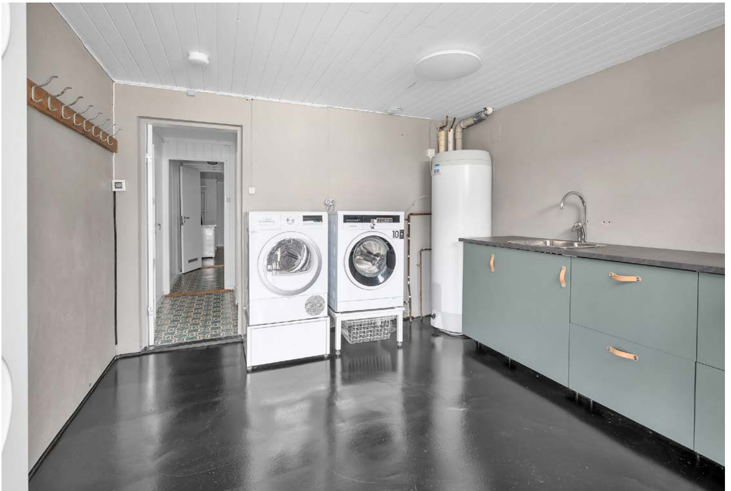
Romslig vaskerom med opplegg til vaskemaskin og tørketrommel. Varmtvannsbereider på 300L.
