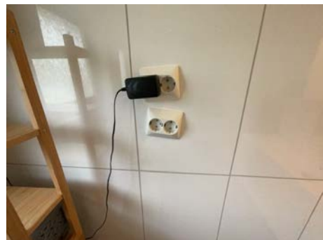
Bilde viser eks. på skjeve/løse stikkontakter
