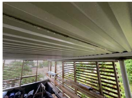
Bilde viser eks. på drypp/lekkasje under stålplater
