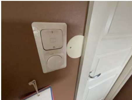
Bilde viser eks. på bryter som er tapet fast og blindlokk på siden av bryterpanel
