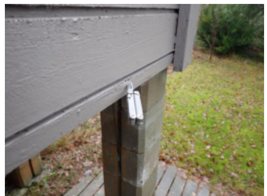
Sporadiske plasser med råteskader
