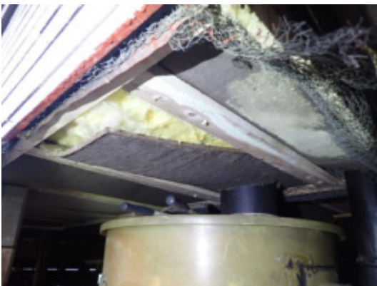
Løs plate i stubbegolv
