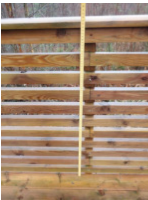
Rekkverk er lavere enn dagens krav på 100cm
