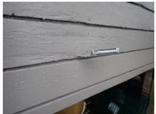
Sporadiske plasser med råteskader
