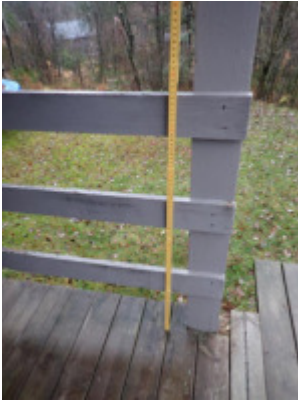
Rekkverk er lavt og har store åpninger mellom spiler.
