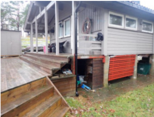
Det mangler rekkverk på trapp til terrasse
