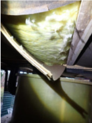
Brudd i stubbegolv med eksponert isolasjon.
