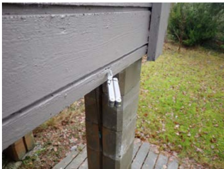
Sporadiske plasser med råteskader
