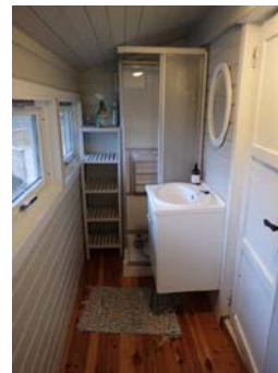
Rommet har kun ventiler i vinduer
