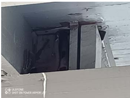
Del av kledning mangler i øvre hjørne
