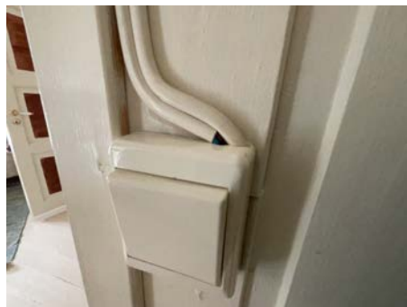
Bilde viser eks. på ufagmessig utførelse
