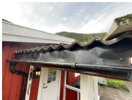
Bilde viser eks. ikke fagmessig utførelse, skruer gjennom skvettssinkbeslag.
