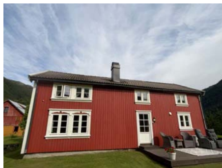
Ingen snøfangere montert
