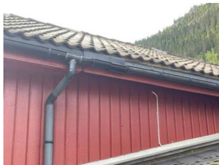
Bilde viser eks. på mangelfull fagmessig utførelse.
