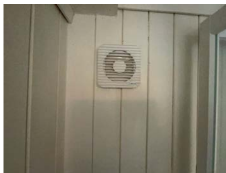
Elektrisk avtrekksvifte plassert i våtsone, ukjent IP-grad
