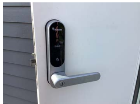
Kodelås ved inngangsdør i 1. etasje.
