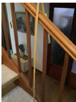
Rekkverk er lavere enn dagens krav
