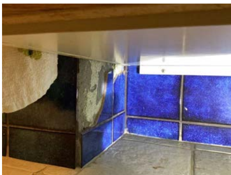
Skade på flis under innredning
