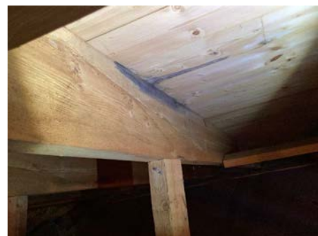
Missfarging på undertak
