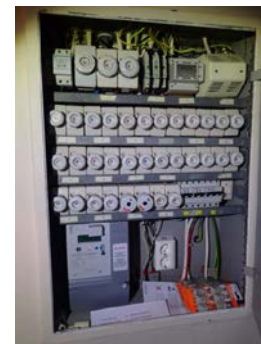
Eldre anlegg med skrusikringer og automatsikringer
