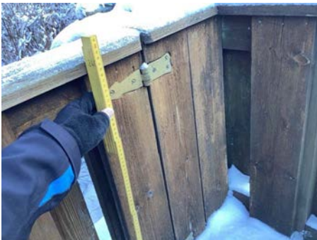
Rekkverk er lavere enn dagens krav
