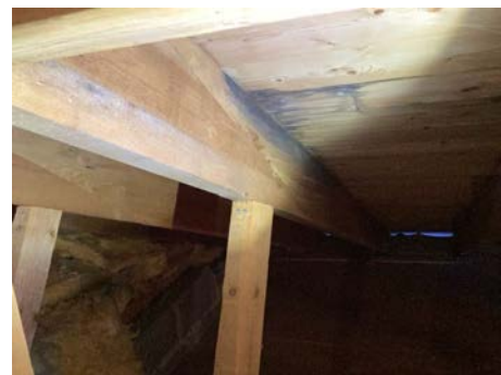
Missfarging på undertak
