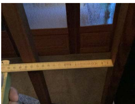
Stor åpning mellom spiler
