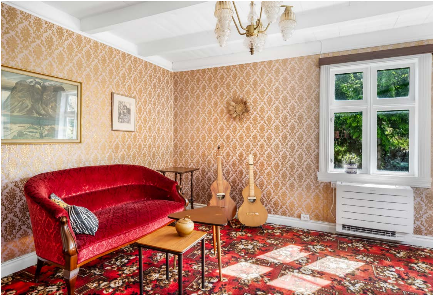
I tv-stuen er det monteret en nyere varmepumpe.
