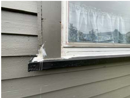
Råte på kjøkkenvindu.
