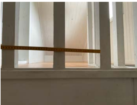
Åpning i rekkverk større enn 10cm.
