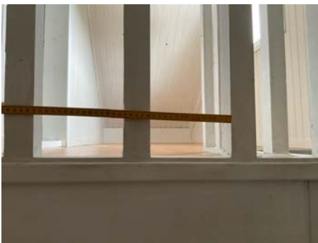
Åpning i rekkverk større enn 10cm.
