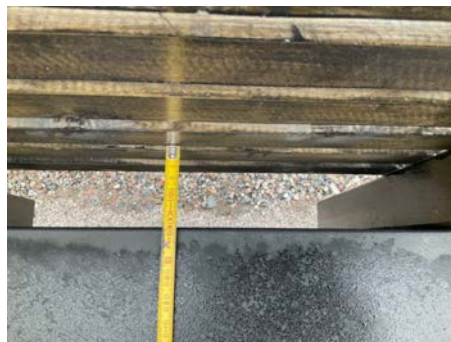
For stor glippe mellom rekkverk og terrassegulv
