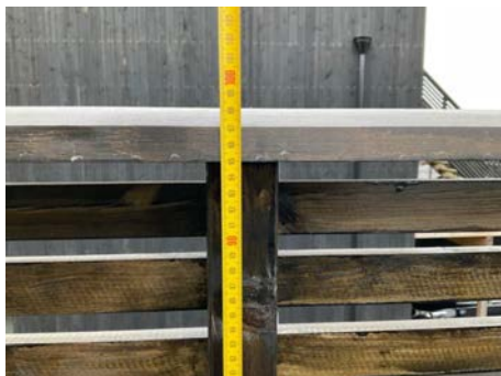
Rekkverk mangler ca 2 cm på høydekrav
