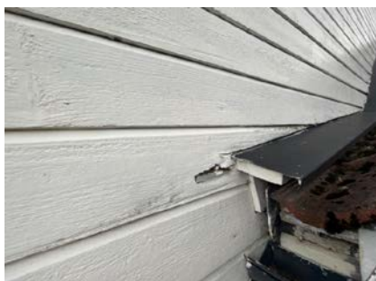
Råte i nedre del av kledning ved vannbord
