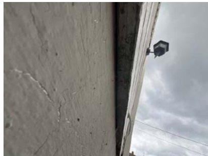
Ingen lufting bak kledning.
