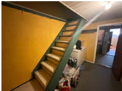
Trapp til kjeller mangler rekkverk.
