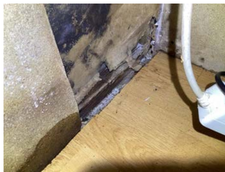
Synlig skade i svill
