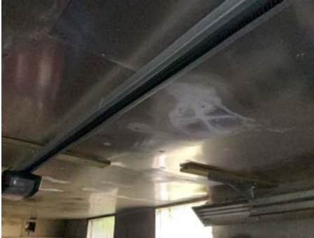
Korrosjon på plater i himling
