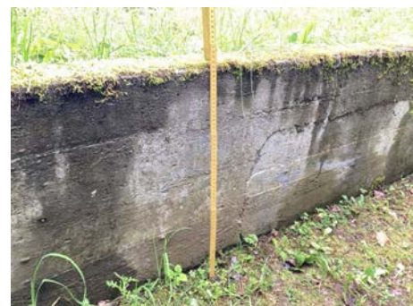
Høyden på støttemur bak bolig er over 50 cm
