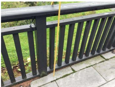
Rekkverk lavere enn dagens krav.
