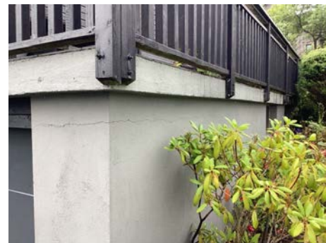
Horisontal sprekk ved garasje
