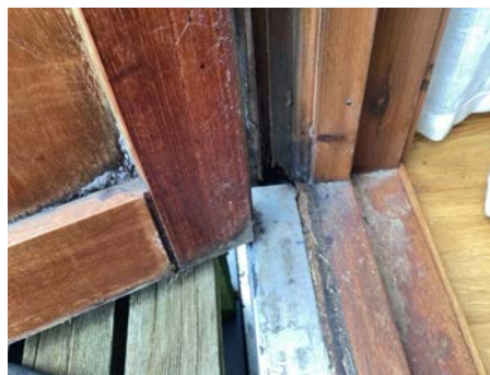
Råteskade i balkongdør
