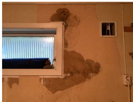
Skader rundt vindu
