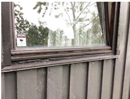
Vindu med råteskade
