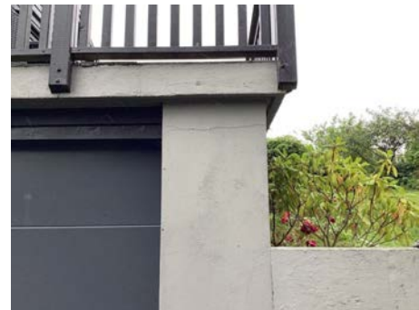
Horisontal sprekk ved garasje
