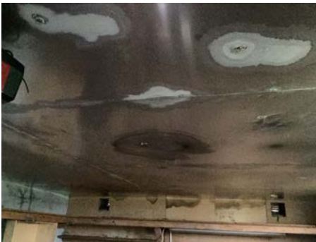
Korrosjon på plater i himling
