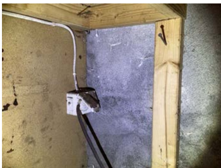
Antydning til saltutslag
