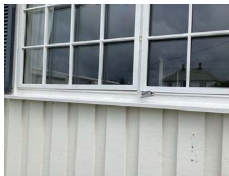
Råteskader i karm
