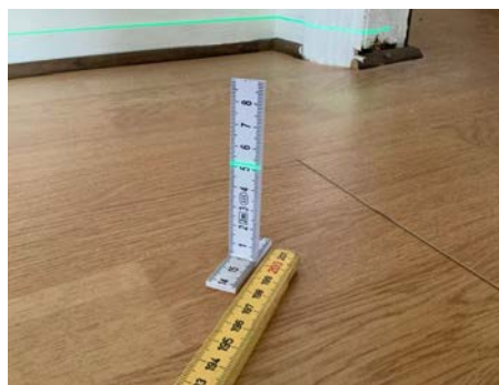
22 mm på 2 meter på gang på loft måling
