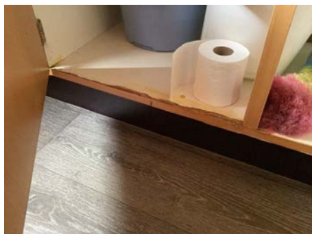
Fuktskader på bunnplate
