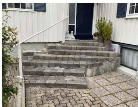
Steinsatt trapp mangler rekkverk
