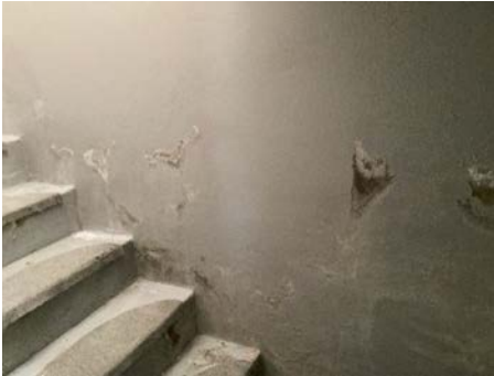
Saltutslag på vegg
