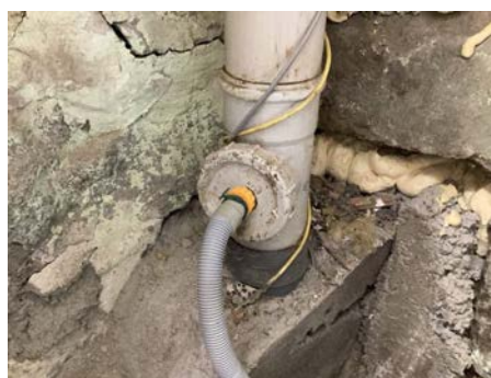
Improvisert løsning. Ukjent hvilken funksjon.
