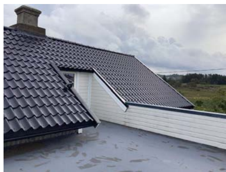
Taket mangler snøfangere.
