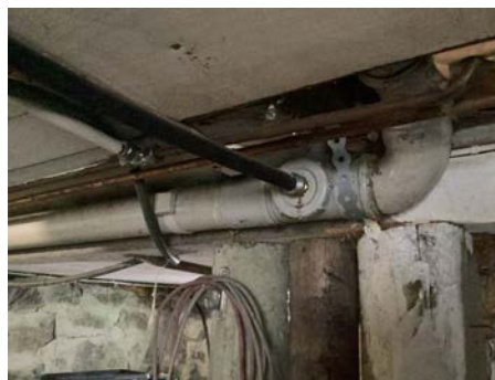
Improvisert løsning. Ukjent hvilken funksjon.
