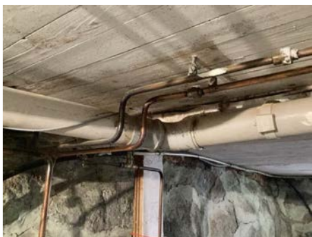
Eldre vannrør i kobber
