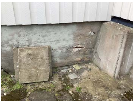
Brudd i overflate på gammel støp, armering eksponert
