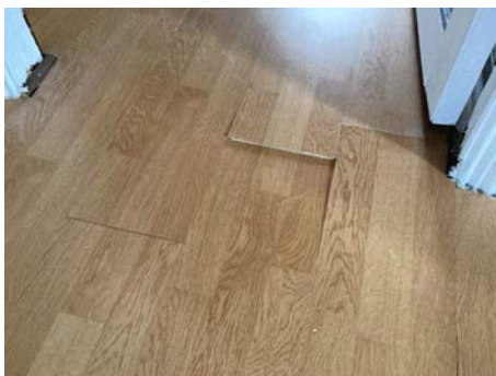
Laminat på loft glir fra hverandre på loft
