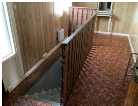
Rekkverk er noe vinglete
