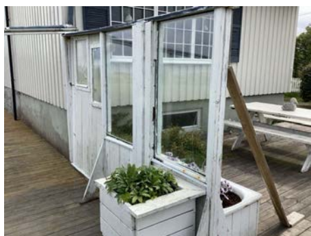
Levegg med skader / sprukket glass og råte
