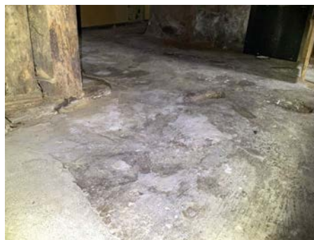
Grovstøpt gul i kjeller med ujevnheter
