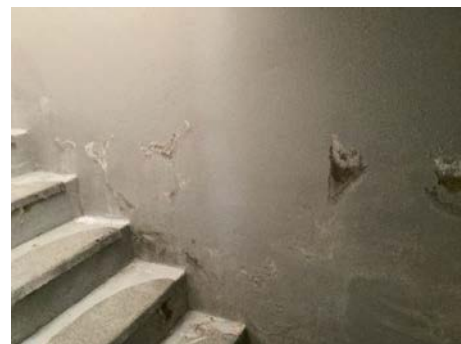
Saltutslag i kjeller
