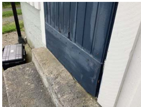
Råteskader i dør
