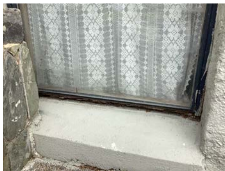
Kjellervindu med råteskade i karm
