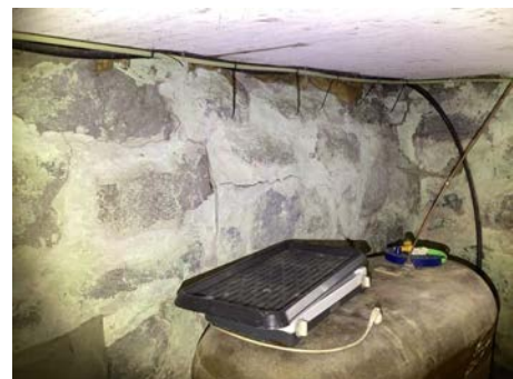
Mindre riss i mørtelfuger
