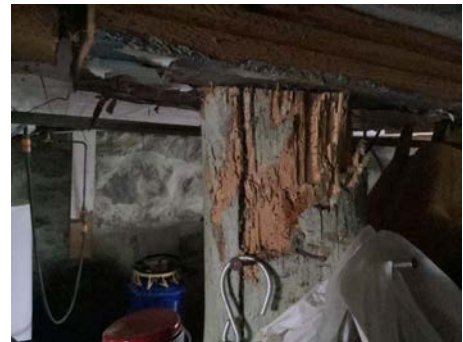
Stolpe med råteskader og spor etter borebiller.
