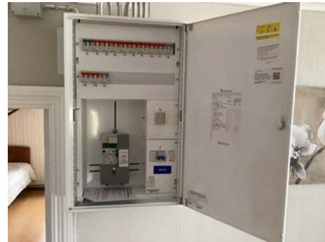
Sikringskap på loft
