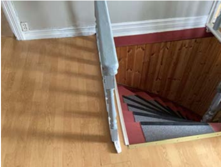
Rekkverk er løst
