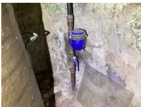
Vannmåler i kjeller
