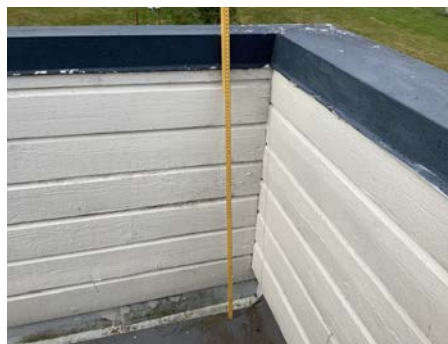
Parapet / rekkverk er lavere enn dagens krav
