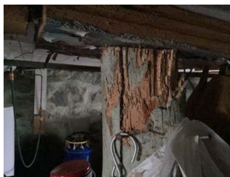
Råteskader i stolpe
