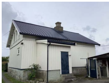
Taket mangler snøfangere.
