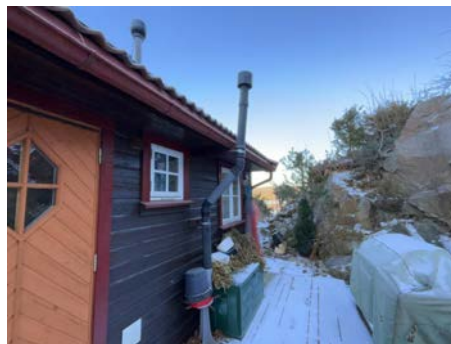
Utvendig avgassrør fra forbrenningstoalett.
