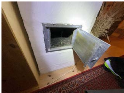
Sotluke mangler sotluke stein eller ubrennbar plate mot gulv.
