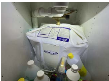
Varmtvannsbereder i kjøkkenskap.
