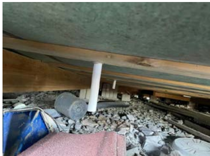
Avløpsrør / gråvannsavløp direkte til terreng.
