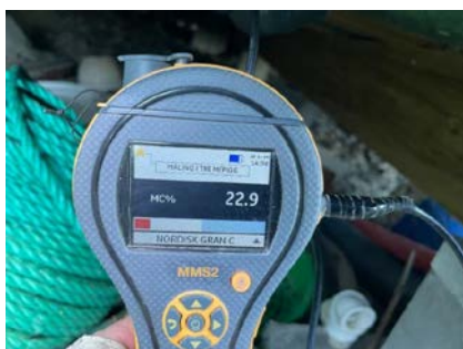
Oppfuktet skillekonstruksjon under baderommets nordlige side.
