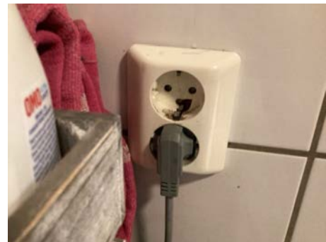
Skade på kontakt
