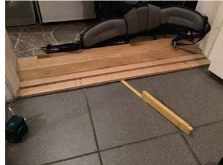
Terskel på dør til bod er ikke stemplet av
