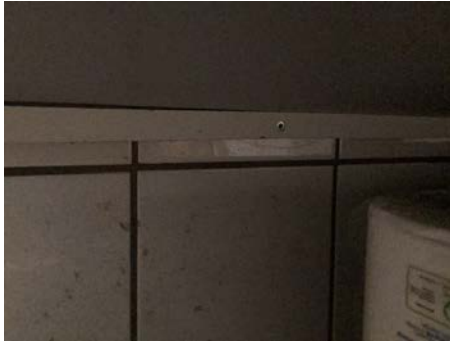
list under servantskap er skrudd fast i vegg hvor det er våtsone.
