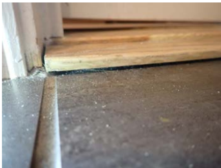
Ingen synlig membran ved terskel
