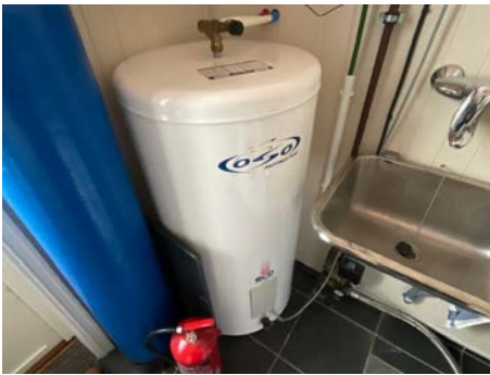
Deksel ved ertilkobling er sprekt.
