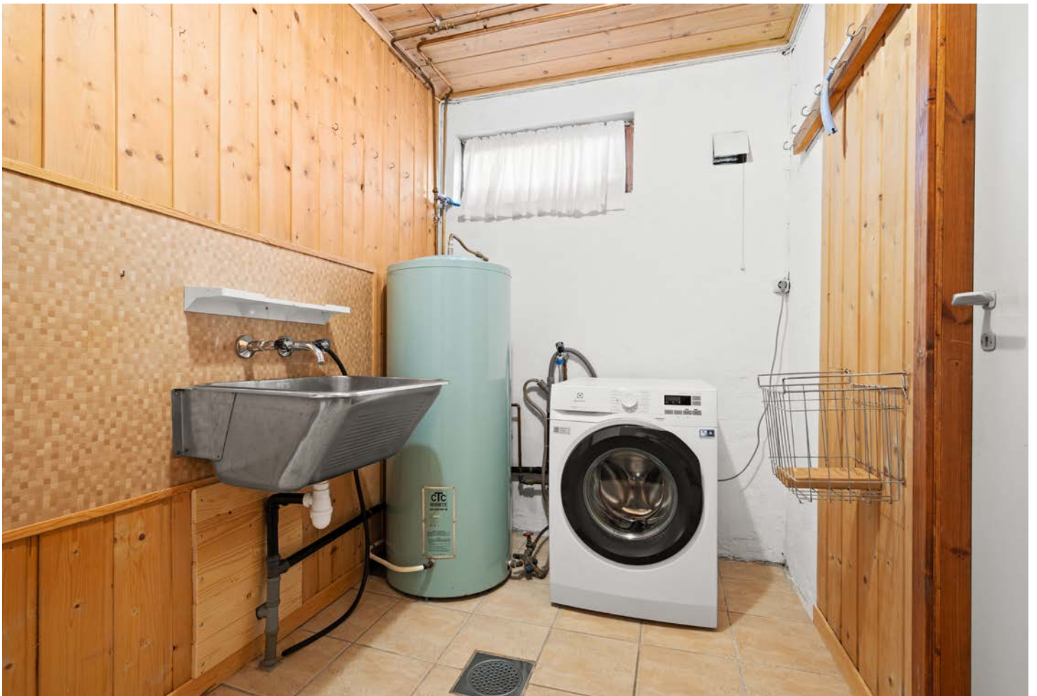
Eget vaskerom i underetasjen. Rommet er utstyrt med varmtvannstank, servant og opplegg for vaskemaskin.
