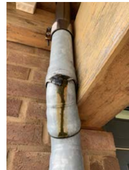
Avløp på terrassen lekker litt i skjøten. TG 2 på avvik.
