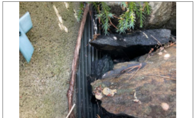
Synlig grunnmursplast registrert på tilbakefylt del (garasje)
