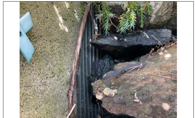
Synlig grunnmursplast registrert på tilbakefylt del (garasje)
