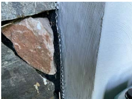
Synlig grunnmursplast registrert på tilbakefylt del
