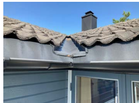
Synlig slitasje på beslag. Noe avskalling av plastbelegg i overganger/skjøt
