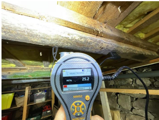
Fuktmåling - Skillekonstruksjon fra krypromssiden - Høyt fuktnivå / vektprosent.
