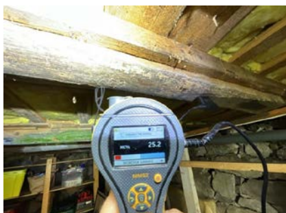
Fuktmåling - Skillekonstruksjon fra krypromssiden - Høyt fuktinnhold / vektprosent.
