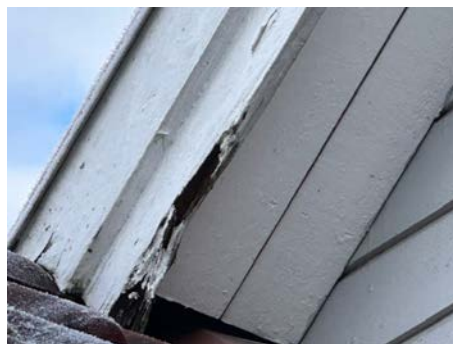
Råte i vindskibord
