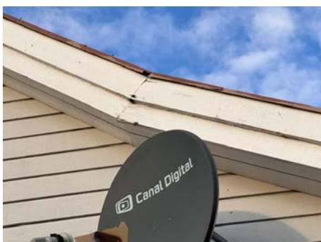
Råte i vindslibord
