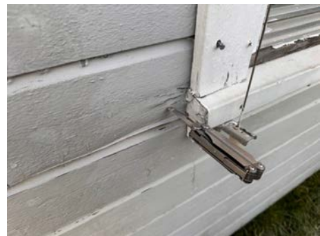
Råte i kledning
