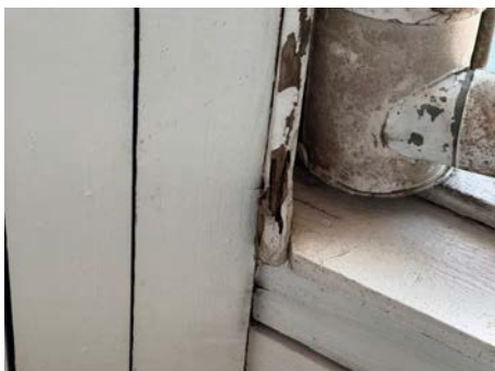
Råte i pannebord
