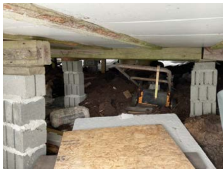
Synlig skjevhet i bjelke, langt mellom bærepunkt.
