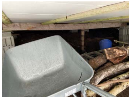
Synlig skjevhet i bjelke, langt mellom bærepunkt.
