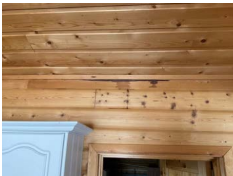
Eldre fuktmerke ved kjøkken.
