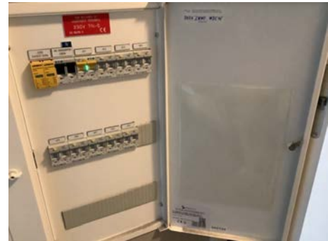
Sikringsskap står plassert i gang.
