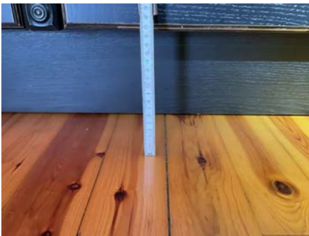
Utkaststrek laser er 11 cm på målestokk, bilde viser ca. 20 mm høydeforskjell på kjøkken innenfor 2 meter.
