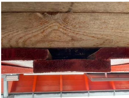
Bilde viser eks. på manglende musetetting.
